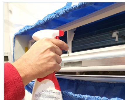
Pulizia batteria senza telo di protezione
